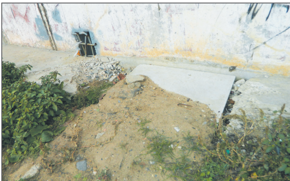
Этим летом Тутаевская ПГУ произвела замену участка сетей около дома № 113, но при этом была задета отмостка, сделанная менее года назад, и при благоустройстве она не была восстановлена.
