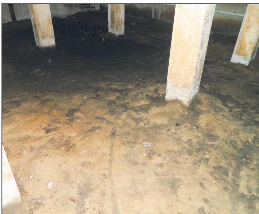
Подвал дома частично отсыпан песком, но и это не спасает его от подтопления.
