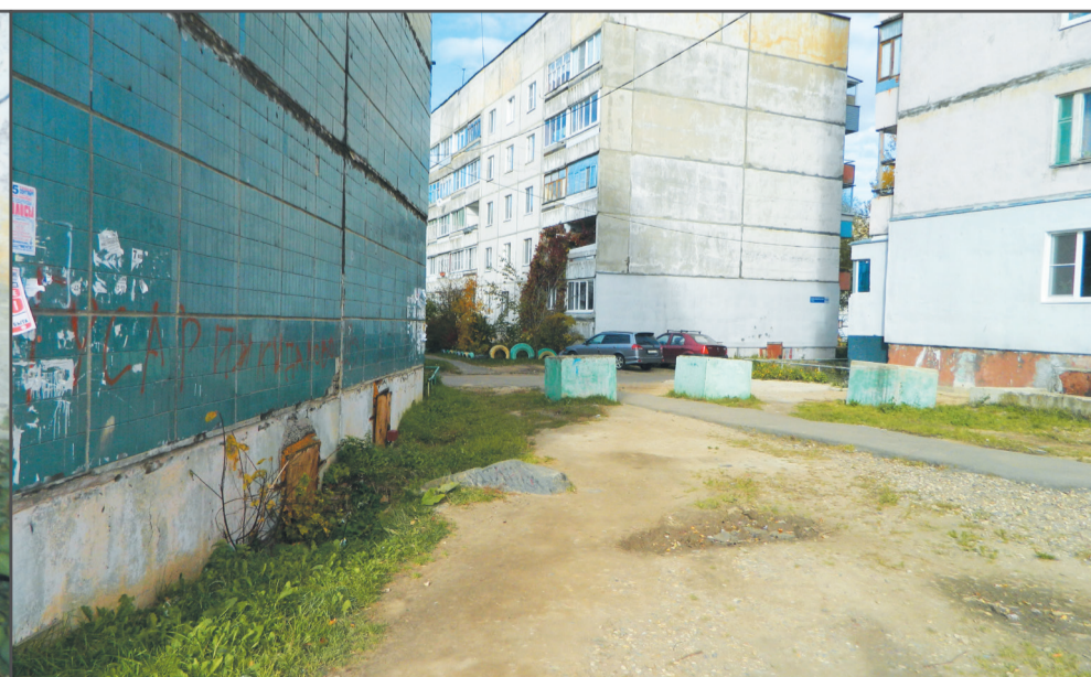
В следующем году планируется строительство отмостки у дома № 115. В отчаянии жители даже согласны на сооружение здесь заградительной дамбы из песка для задержания воды.
